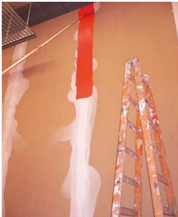
Die Schrauben werden mit Klebepunkten abgedeckt und danach der Stoß zwischen den Tischlerplatten gespachtelt und geschliffen. Anschließend wird der Stoß satt mit Farbe beschichtet und mit Hilfe
